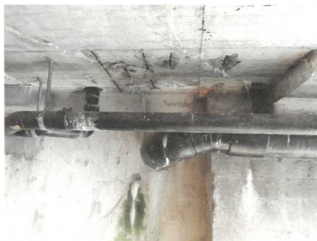
Schwimmbadleitungen und Bewehrungs-eisen, mit zu geringen Betonüberdeckung
